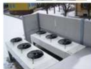
Mur anti-bruit protègent les habitations riveraines du bruit des équipements de ventilation (Acouever Iso)
