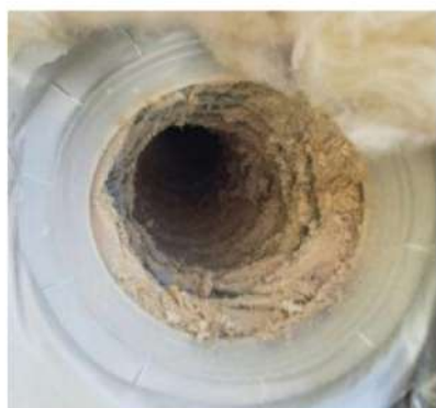
État d'une gaine « classique » non entretenable après 4 ans d'utilisation
