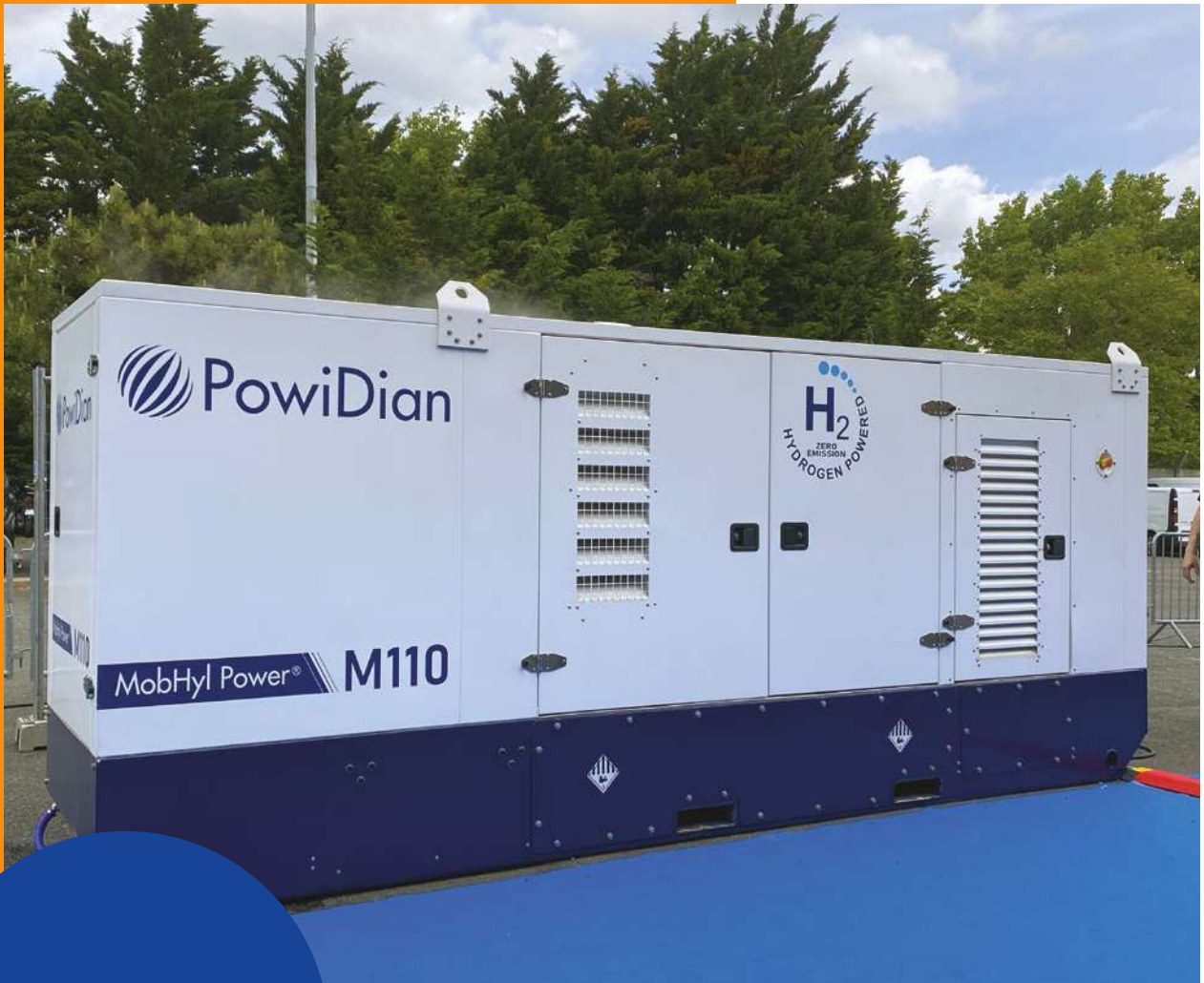
Groupe électrogène à hydrogène M110 de Powidian
