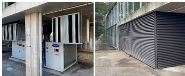
Intégration des deux nouvelles pompes à chaleur dans un local technique dédié
