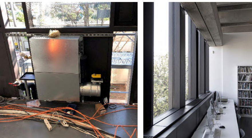
Intégration des ventilo-convecteurs et de l'air neuf dans les murs rideaux
