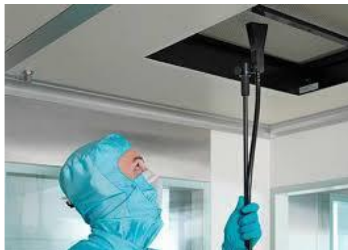
Tests d'intégrité de filtres
