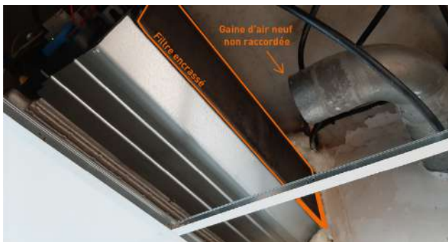
Figure 5 : Ventilo-convecteur non raccordé en faux-plafond
