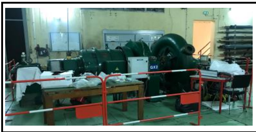
Un des 2 alternateurs pour besoin électrique du barrage
