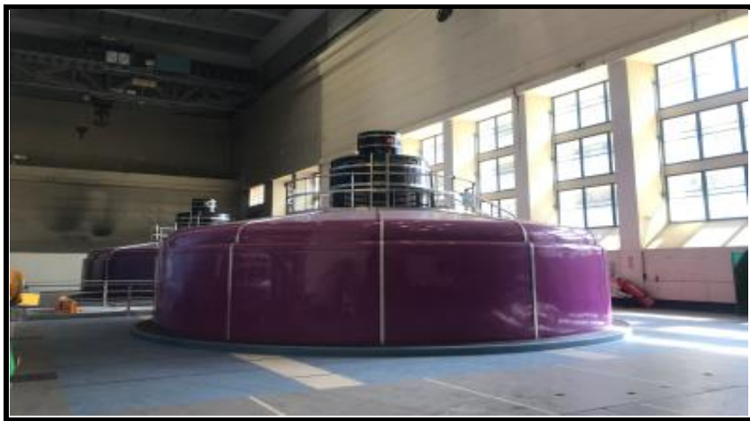
Les 2 Alternateurs : Puissance Totale 235 000kW vers le réseau en 225 000 volts
