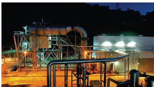
La centrale-geothermique de Bouillante
