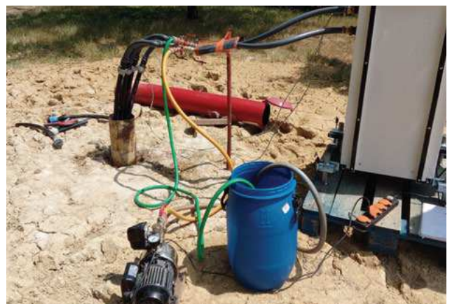
Test de réponse thermique sur la première sonde à l'école du bois d'amour - Saint Benoit (86)
