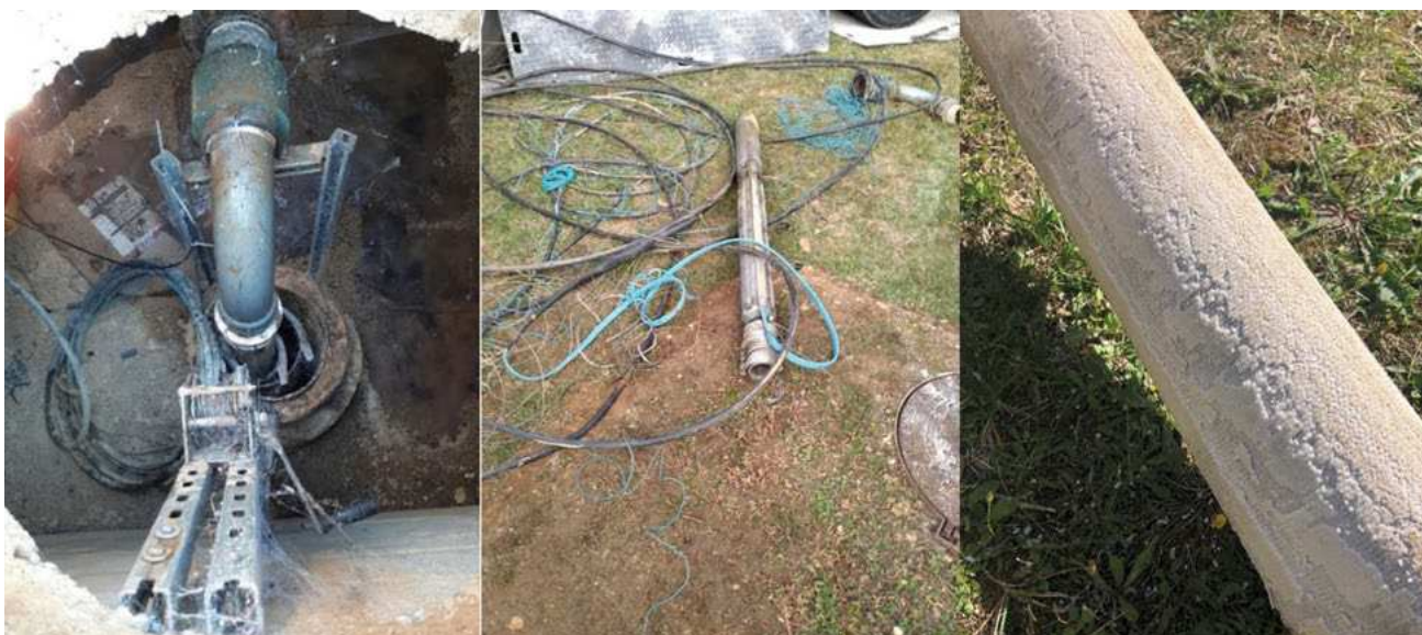
Photos prises sur le forage d'exhaure de l'Agora lors de la dépose des équipements préalables au contrôle endoscopique : À gauche : tête du forage avec crosse de refoulement avant dépose de la pompe – espace annulaire réduit et absence de tube guide pour pose de sonde de niveau Au milieu : pompe immergée-partie hydraulique déposée avec partie moteur désolidarisée et câbles d'alimentation et de maintien rompus lors de la dépose À droite : colonne d'exhaure souple initialement et rigidifiée par le dépôt de calcaires en lien direct avec la qualité de l'eau souterraine
