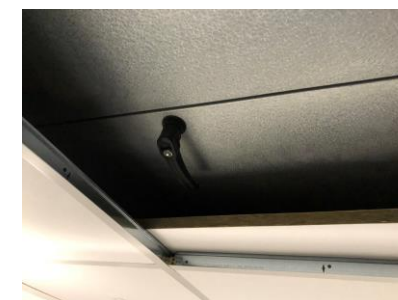
CTA en faux plafond
