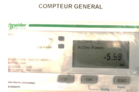
Compteur non opérationnel
