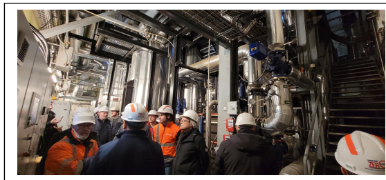
Des installations d'une propreté remarquable, quasiment à l'état neuf
