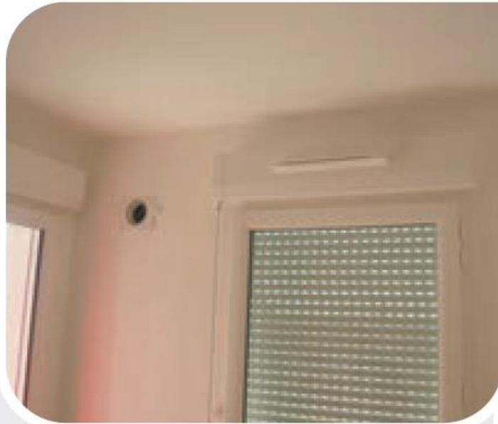
Double entrée d'air dans une même pièce
