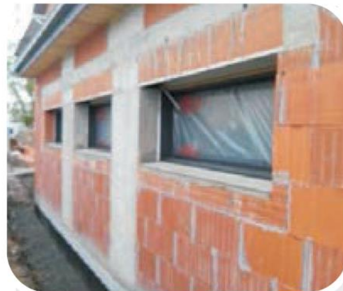
Pont thermique de plancher intermédiaire non traité sur toute la périphérie
