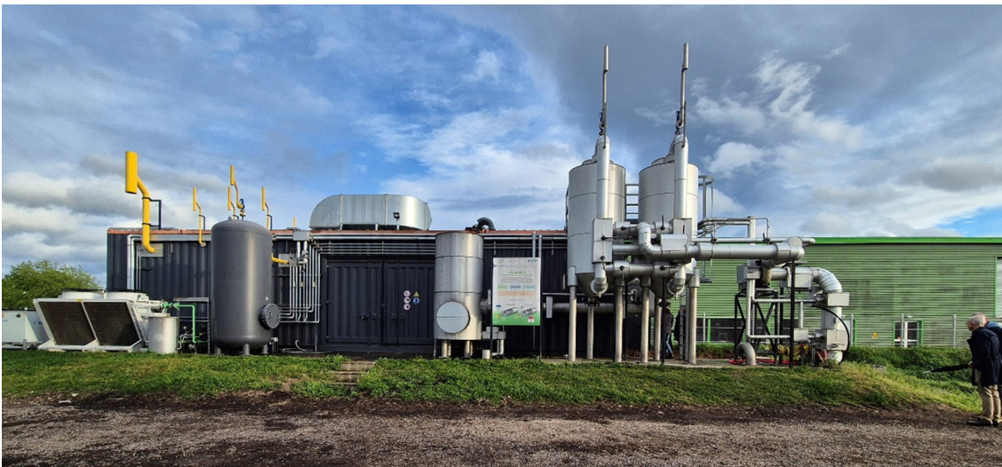
L'unité de traitement et de contrôle du gaz
