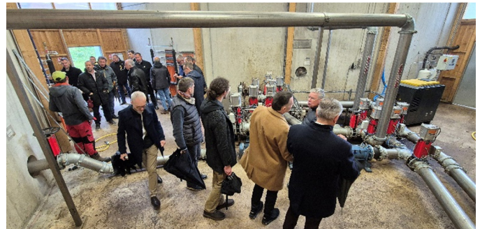
Le système de pompes d'alimentation des cuves
