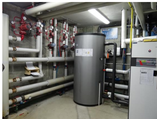
Après : ballon solaire ECS 1000L + préparateur dédié ECS 35 KW
