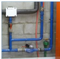
Compteur d'ECS sur l'alimentation EF du ballon
