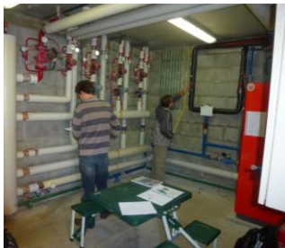
Avant : chaufferie de 288 kW toute l'année
