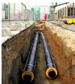
Réseau de chaleur
