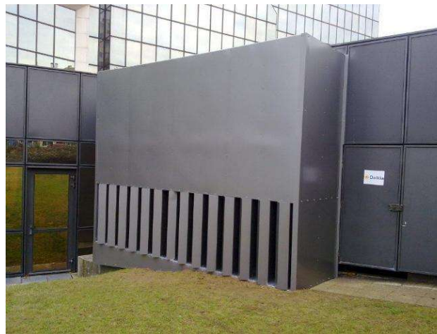
Capot de 13 VRV avec baffles de ventilation au rejet (Akustike)
