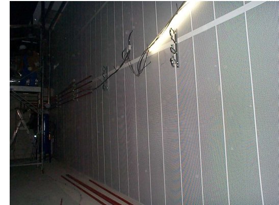
Habillage mural local GE, avec fixation des canalis sur panneaux (Akustike)
