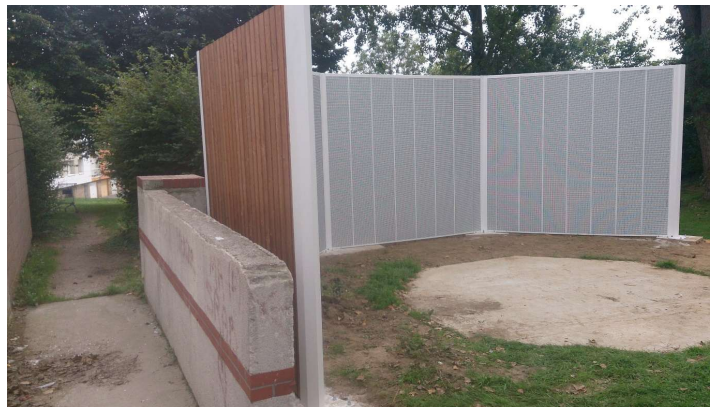
Écran acoustique tertiaire avec habillage extérieur en bois (Akustike)
