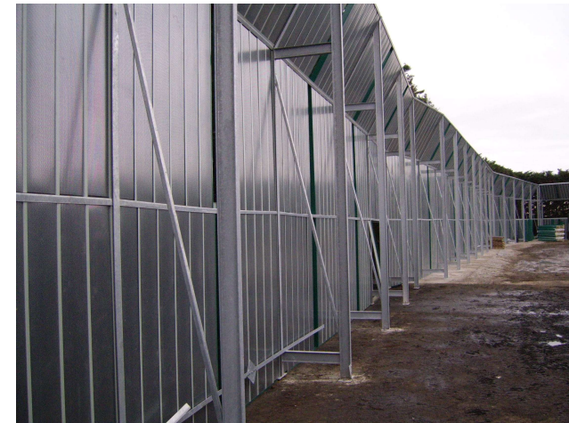
Mur anti-bruit protégeant les habitations riveraines du bruit des équipements de ventilation (Akustike)
