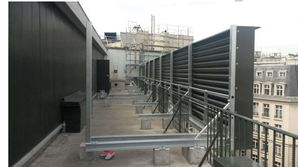
Ecran de grilles acoustiques (Akustike)
