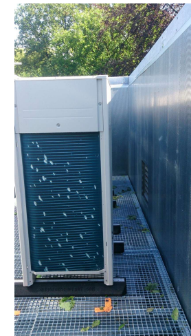
Correction terrasse technique, avec panneaux AKO, version 100mm et finition galva (Akustike)
