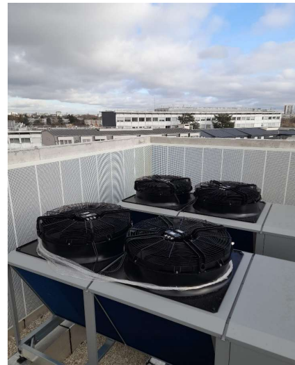
Correction acoustique du local GE (Akustike)
