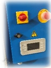
Régulation câblée d'usine
