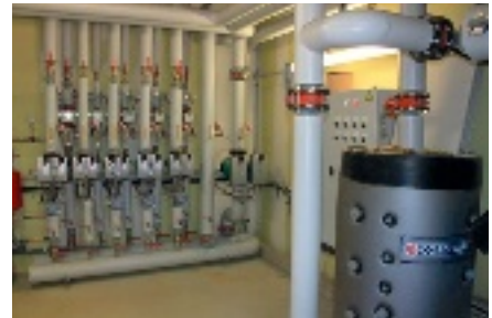
Image 4 Local des pompes à chaleur
