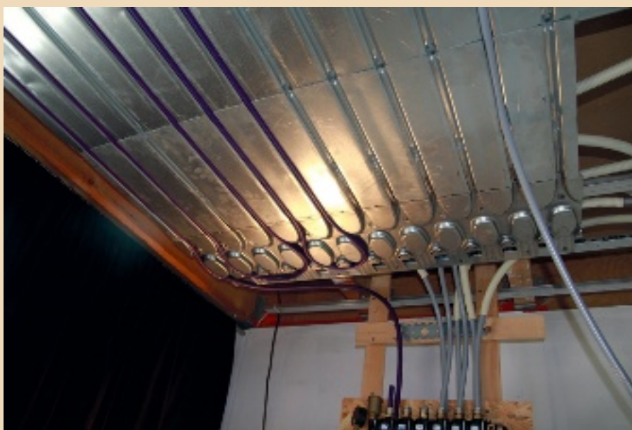
Figure 4 Les tubes de diamètre 13/16 du plafond réversible sont placés dans des diffuseurs métalliques derrière les plaques de plâtre des plafonds.
