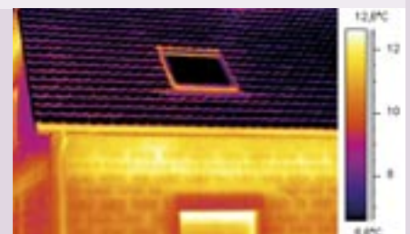
Figure 1 Thermogramme montrant de la vapeur d'eau au travers des agglomérés et de l'enduit.
